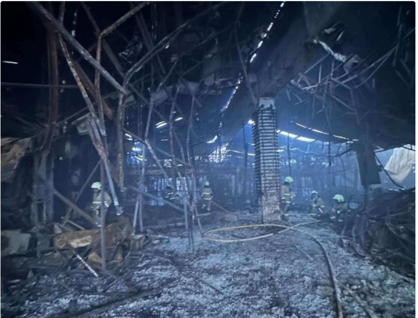
Glodok Plaza yang Hangus Terbakar
